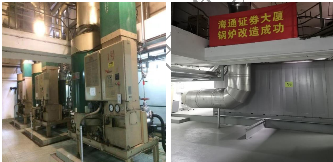
三台燃气蒸汽锅炉（改造前）
