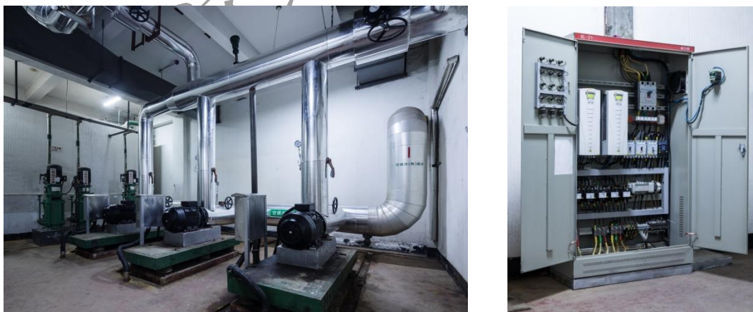
图 5.32 水泵及变频控制柜
